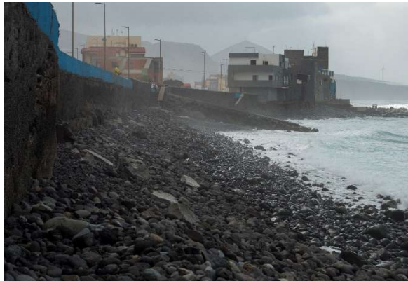
Figura 10. Pérdida de callao, paseo marítimo de El Altillo
